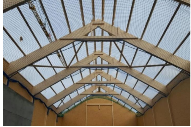
Auffangnetz bei Hallenkonstruktion
